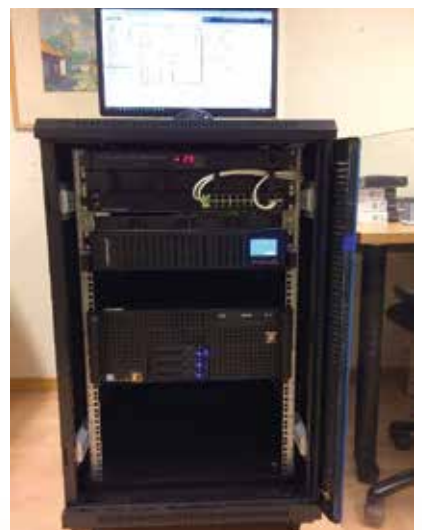
Serverskap for scada, overvåkning og filserver.
