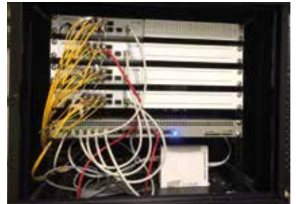
Hovednettverksskap for fibernettet.
