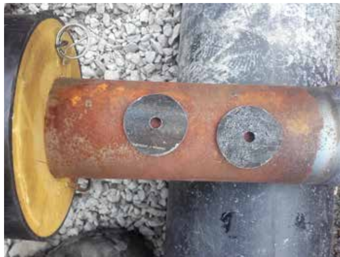
Metallbit fra røret som er anboret
