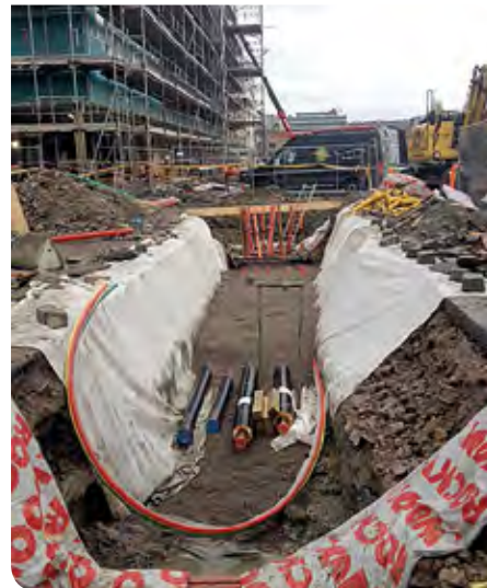
Fjernvarme og fjernkjøling til Værstetorvet 1
