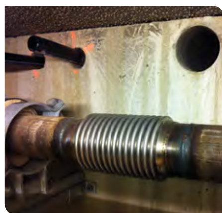
Kompensator i kulverten i Bryggeriveien
