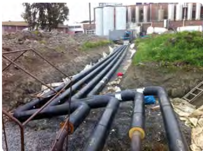
Trase og kundesentral i container hos Mills fabrikk
