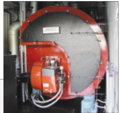
Oljekjele i containersentralen.
