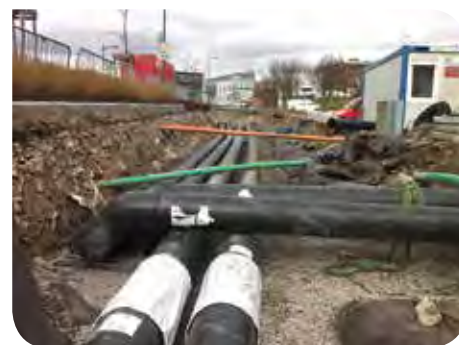
Fjernvarme/fjernkjøling mot Bjølstad
