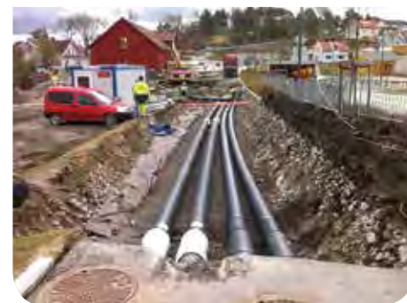
Fjernvarme/fjernkjøling mot Bjølstad
