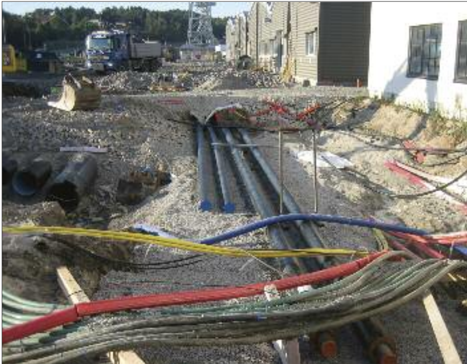
Kryssing av kabler med fjernvarme og fjernkjøling på Værste.
